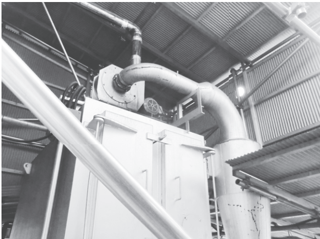
もみ殻を燃焼させるボイラー
