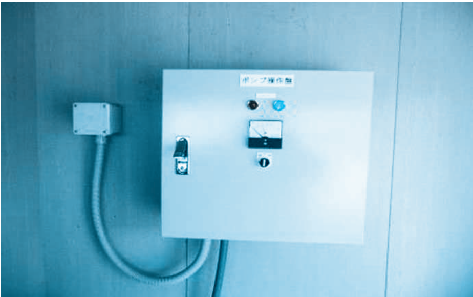
定刻で一定時間の散布が可能なシステムの制御盤。 農家の労働力の省力化を目的として提案した。
