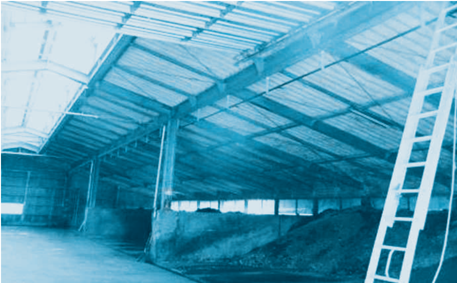
三郷堆肥センターの予備調整施設3に設置した自動散布装置の配管。 霧状に液体が散布される。
