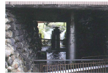
ポンプによる排水（手前がわさび畑）
