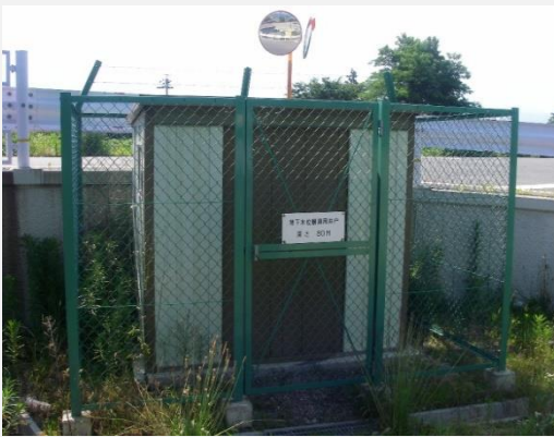
地下水位観測箇所
