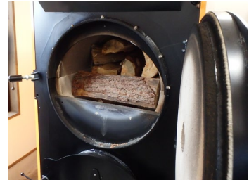
天平の森の薪ボイラー
