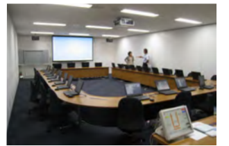
災害対策本部室の事例：災害時に指揮の拠点となる部屋。通信連絡設備等を備えています。
