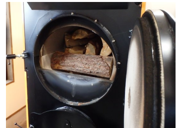
天平の森の薪ボイラー
