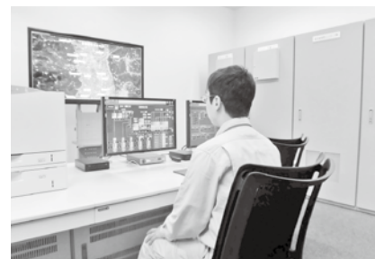
水道施設の一元管理をはかる 中央監視室（本庁舎内）
