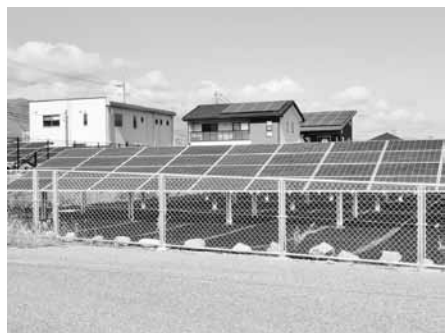
民家近くに設置された太陽光パネル
