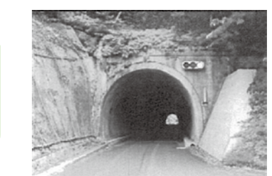
通行制限のあるかいよし会吉トンネル
