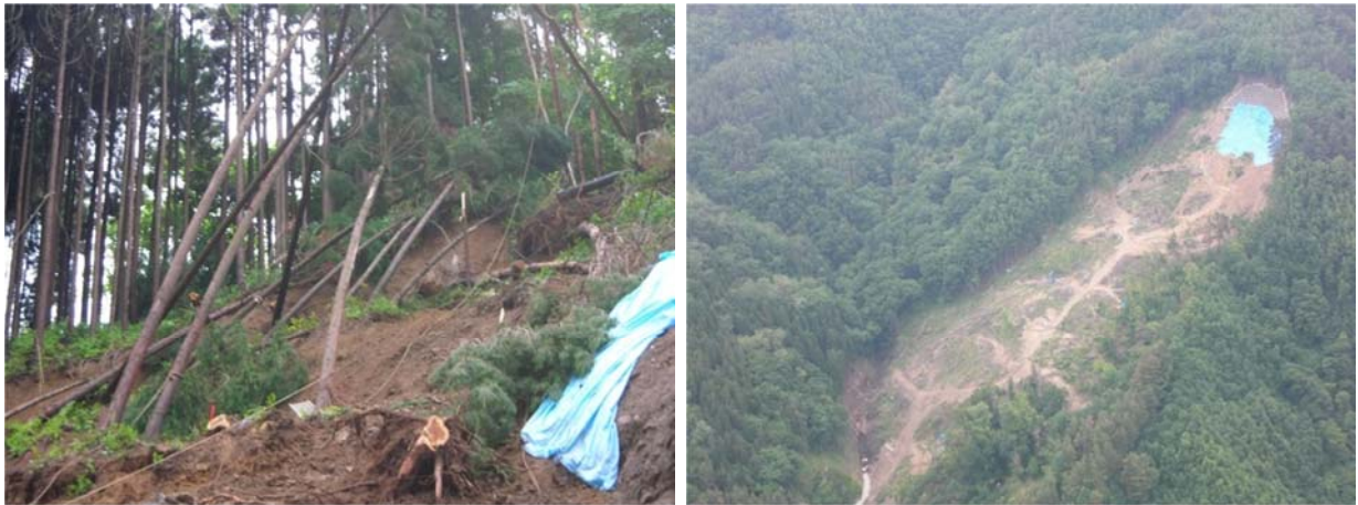
明科潮沢区の崩落現場（平成 22 年 8 月） ※左写真が被災地下部、右写真が全景
