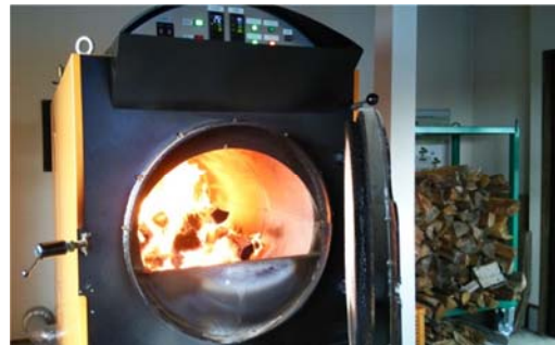
長峰山「天平の森」に設置された薪ボイラー
