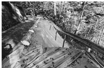
29号カーブ付近の崩落現場(平成29年11月5日)
