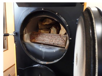
天平の森の薪ボイラー
