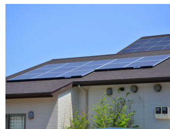
屋根に設置された太陽光パネル
