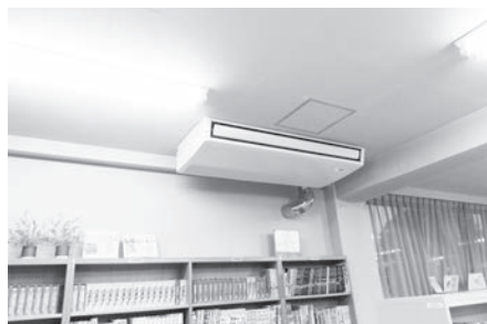
穂高南小学校の特別教室（図書館）に設置されているエアコン
