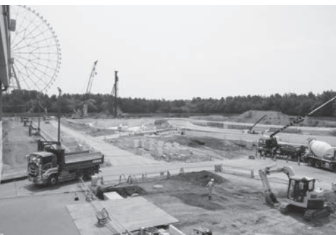
江戸川区葛西臨海公園に建設中の カヌースラローム会場
