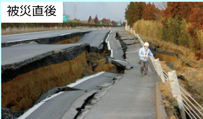
東日本大震災による盛土崩壊（2011.03.11）
