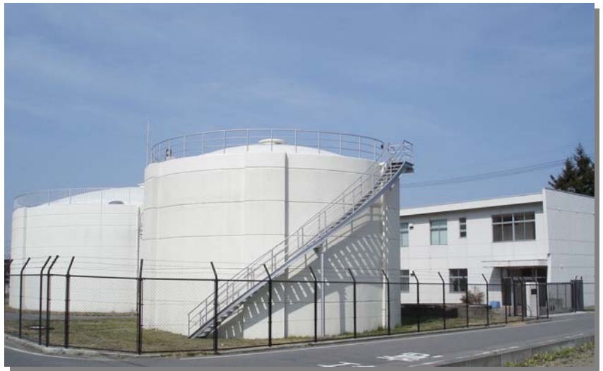
穂高地域 上原水源地・配水池 (重要拠点配水池)
