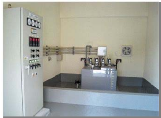
塩素消毒設備
