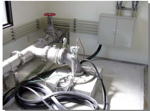
取水ポンプ設備
