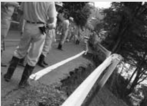
明科木戸地区・県道の路肩崩壊
