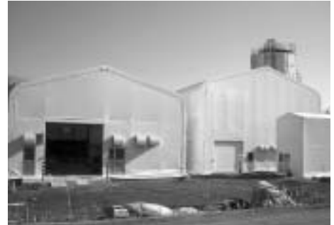
工事中のバイオマスエネルギー地域システム 実験事業の実験施設
