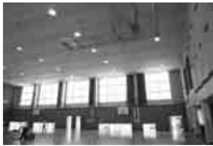
三郷小学校体育館天井
