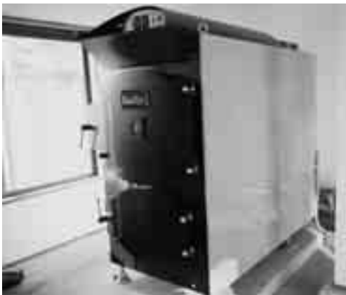
長峰山森林体験交流センター新ボイラー
