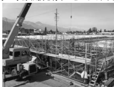
野沢水源ポンプ場
