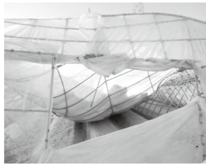
大きく倒壊したビニールハウス
