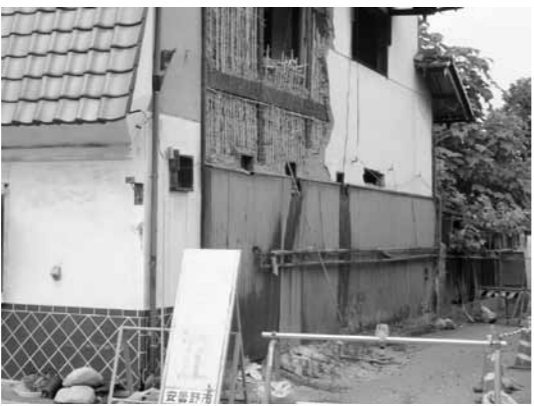
壁が崩落して通行止めの道路
