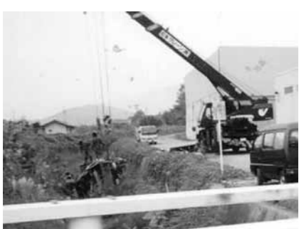
鳴沢川に転落したトラック
