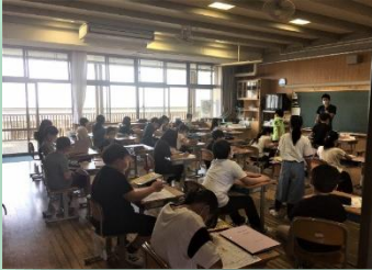
エアコンを設置した小学校の教室
