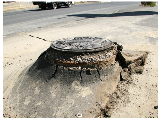
マンホールの浮上
