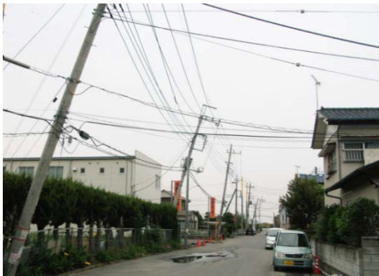
液状化による電柱の倒壊
