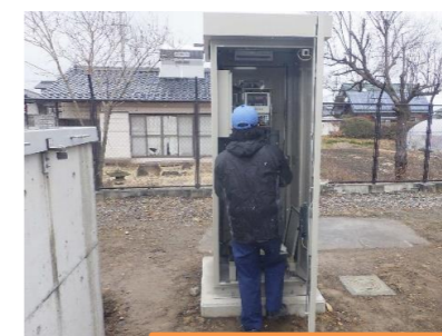
上原水源地濁度計
