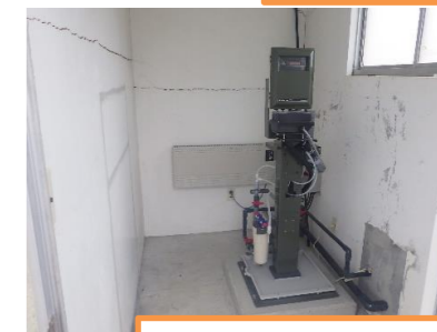
上長尾水源地濁度計
