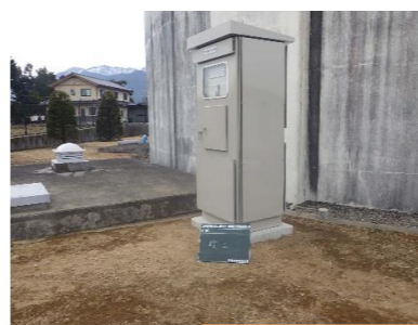
上原水源地 排泥弁制御盤
