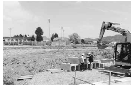
造成工事が始まった穂高北部児童館予定地、後方が穂高北小学校
