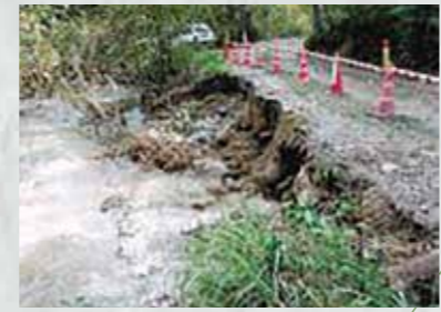
豪雨により浸食した道路
