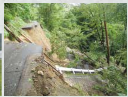
崩落した林道城山線
