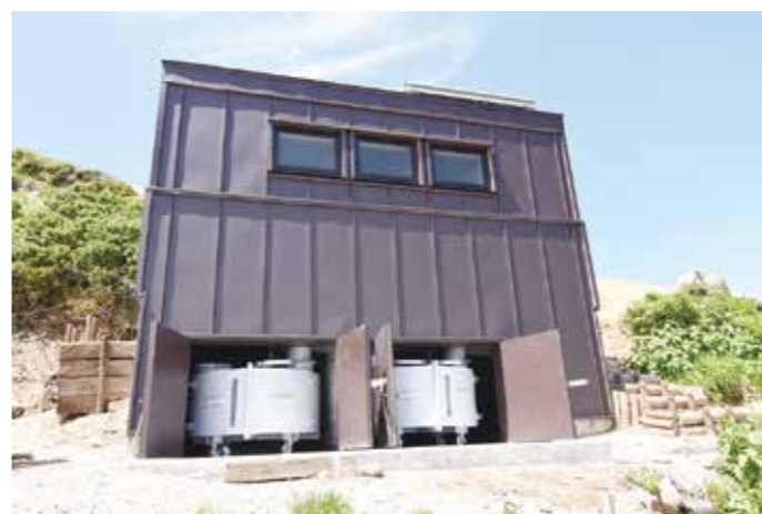
1階に設置したカートリッジ(キャスター付)
