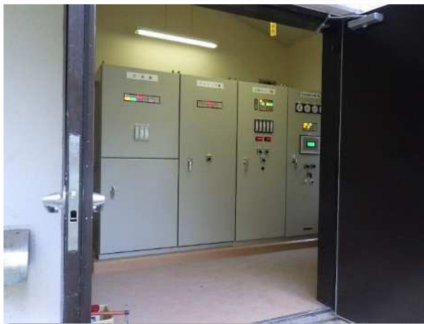
光配水池 電気室内部
