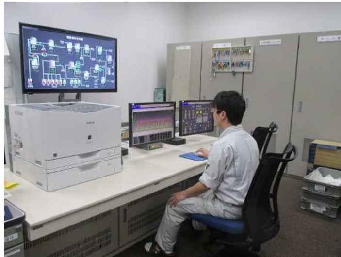
写真 4-10 ■ 遠方監視システムによる情報管理
