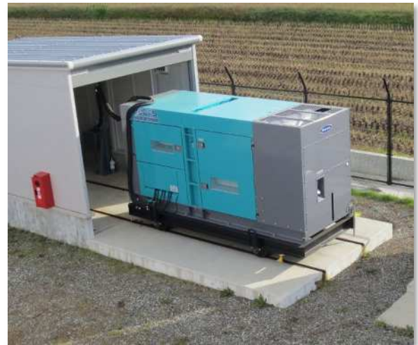
写真 4-4 ■ 非常用電源設備
