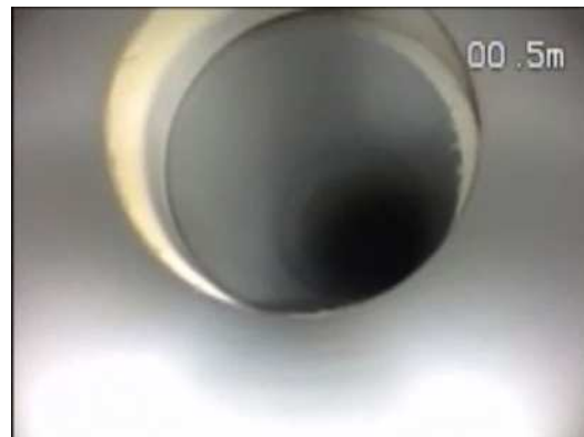
写真 4-2 ■ 洗管後 管内状況
