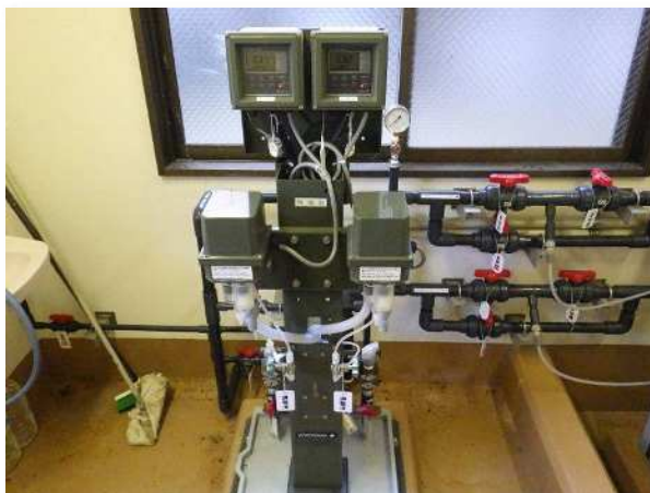
光配水池 残留塩素計
