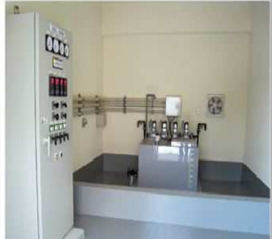
写真 2-2 ■ 塩素消毒設備
