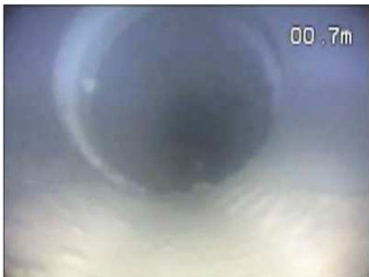
写真 4-1 ■ 洗管前 管内状況
