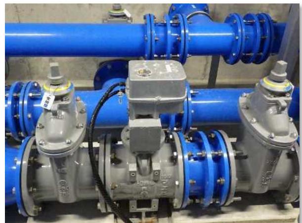
光配水池 緊急遮断弁
