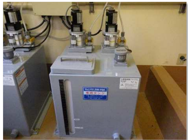
光配水池 塩素消毒設備
