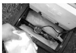
▷水道メータボックス内に、ビニール袋に入れた発砲スチロール材などを入れるのも効果があります。(写真上)
