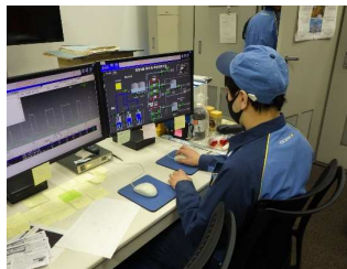
中央監視改造
