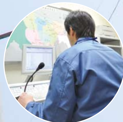
防災行政無線室
