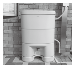
本年度から公共施設にも雨水タンクを導入しています。
