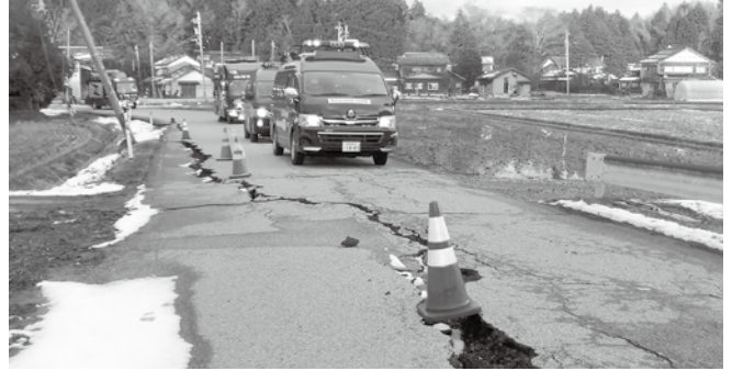
地震により陥没した道路の状況
