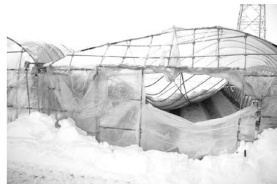
積雪により倒壊した農業用ハウス（堀金烏川）
