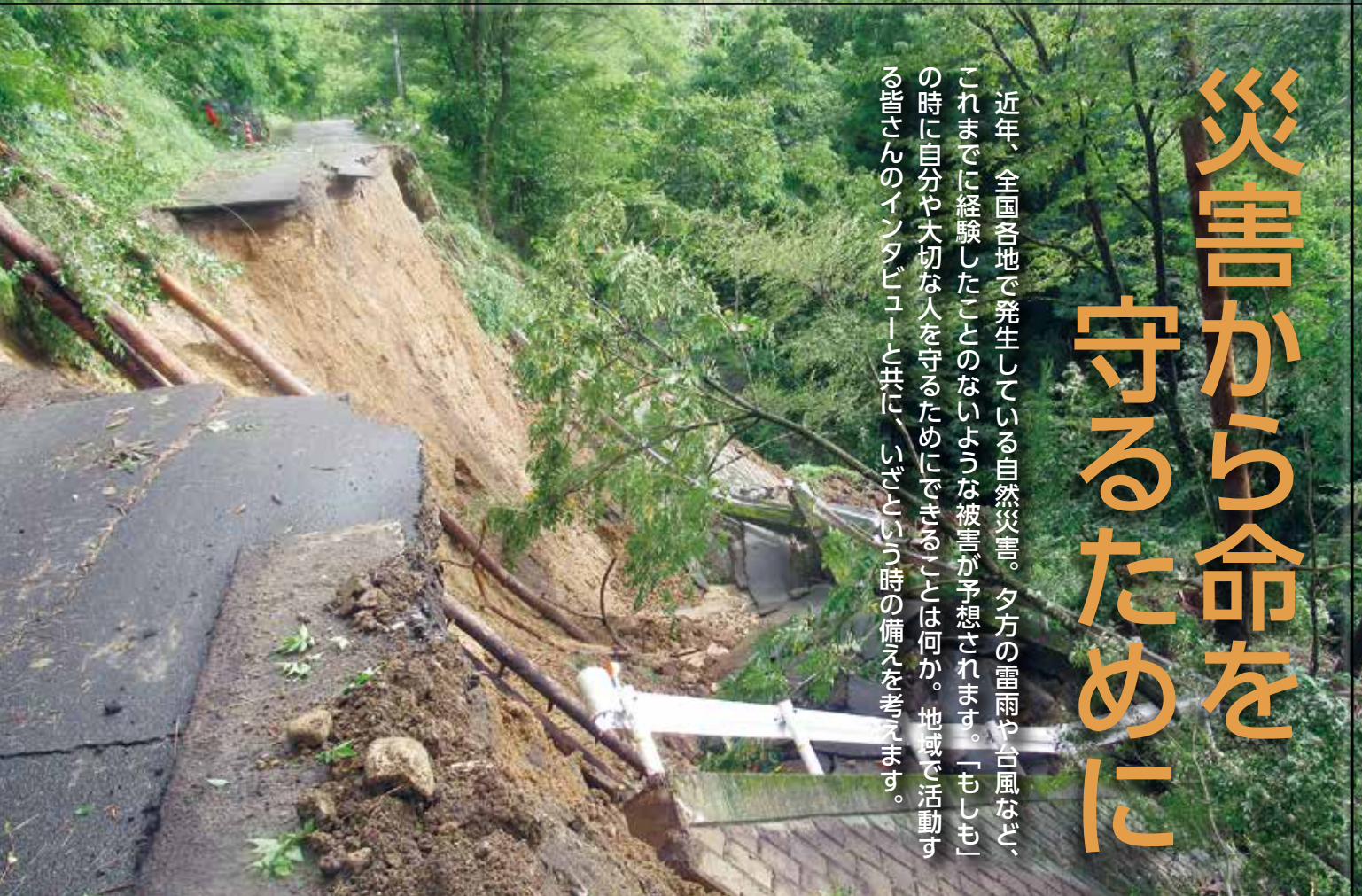
令和3年8月の台風による大雨で崩落した林道長峰線(現在は復旧)
