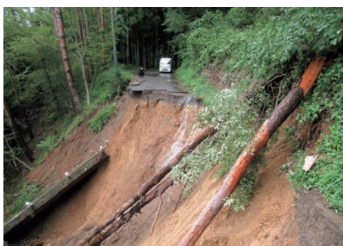
8月の大雨により林道が崩落
