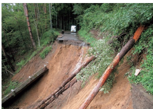
8月の大雨により林道が崩落
