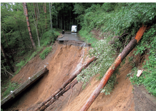
8月の大雨により林道が崩落
