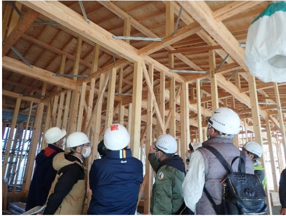
安曇野産材を使った三郷西部認定こども園 の新園舎建設現場を見学
