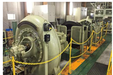
宮城第一発電所
