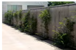
モッコウバラで表面を覆ったコンクリート塀
