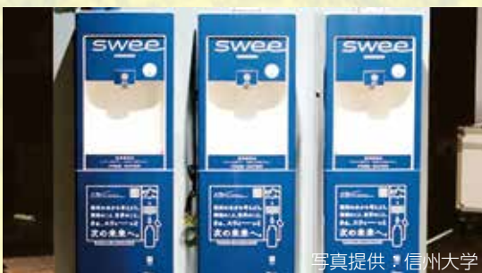
信州大学が開発した浄水機能を持つ給水機sweeを市役所に設置
