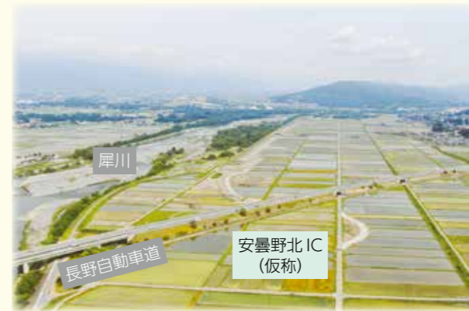
犀川右岸 安曇野北 IC(仮称) 5月時点 用水路の付替え完了
