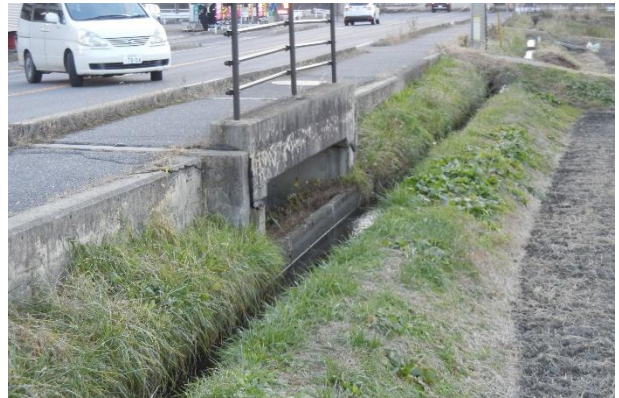
《残された橋の一部》
