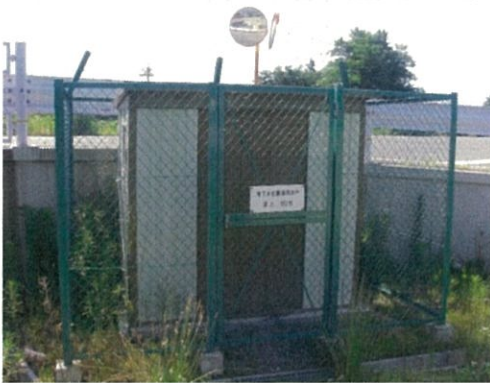
地下水位観測箇所
